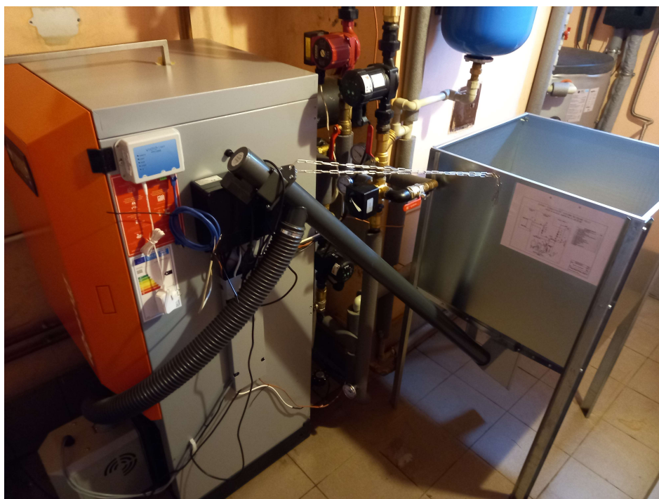
Nowa instalacja kotła c.o.
